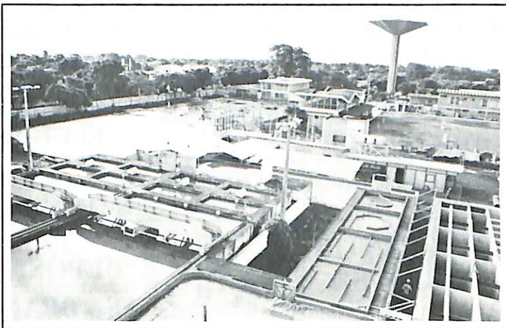
Novo reservatório, em fase de conclusão, com capacidade para doze milhões de litros
