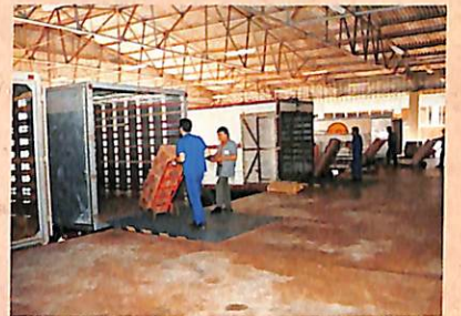
Central de carga/descarga de última geração
