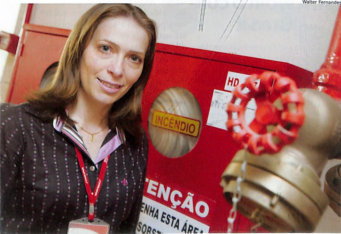
Kátia Gabas, da Spaipa, conta que a empresa adota um amplo sistema de prevenção de incêndio, que inclui treinamentos da equipe, detectores de fumaça e inspeções mensais
